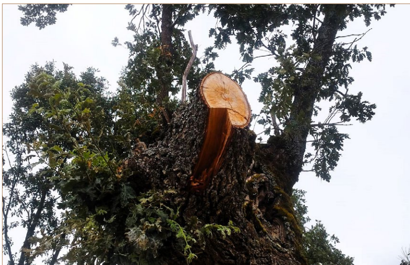
Foto 83. Corte mal realizado que ha generado un desgarro, poniendo en riesgo la capacidad de compartimentación del árbol.
